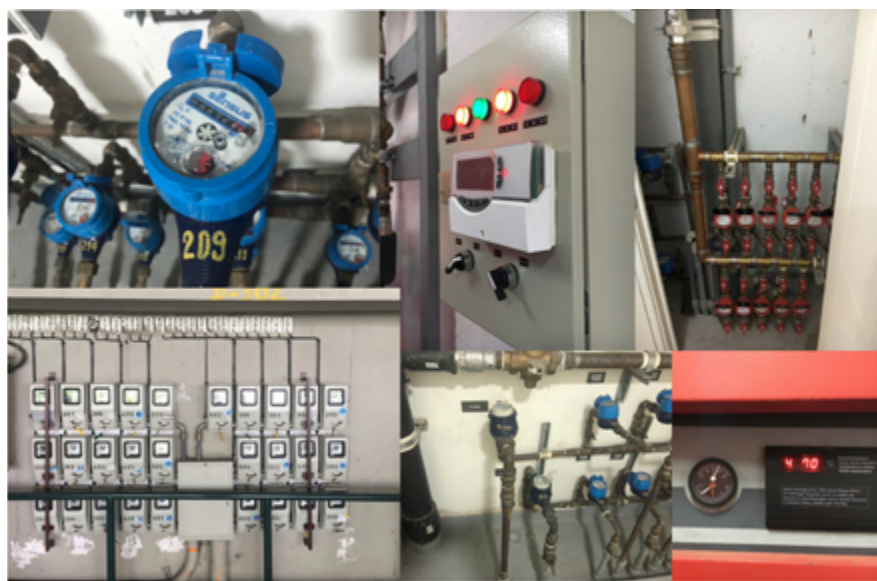
Imagen 3. Dispositivos de medición de agua, gas y electricidad en edificios residenciales en altura. (fuente: Fotografías tomadas por el autor durante las observaciones etnográficas).
