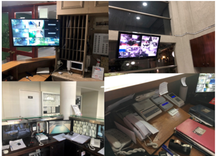
Imagen 4. Decks de ingreso, cámaras y dispositivos de control en edificios residenciales en altura. (fuente: Fotografías tomadas por el autor durante las observaciones etnográficas).
