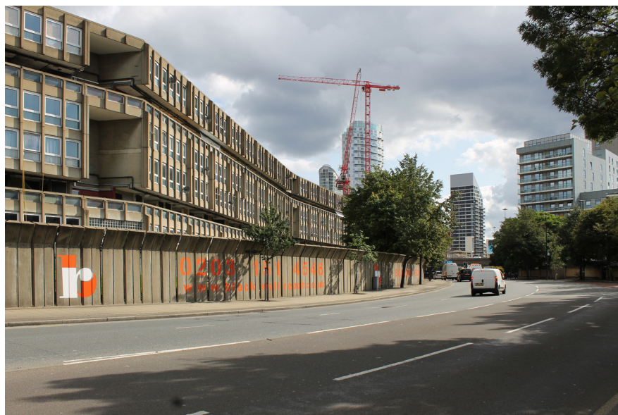
Imagen 2. Bloque oeste del Conjunto Robin Hood Gardens, en preparación para la demolición (fuente: Del autor, 2017).
